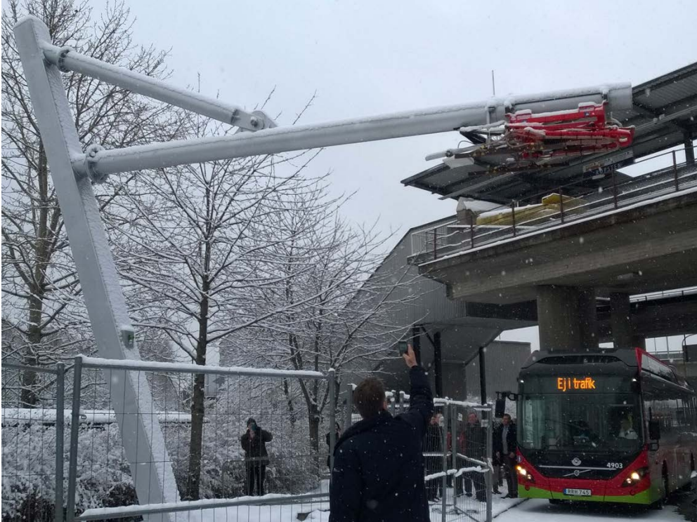
Kuva 7. Sähköbussin automaattinen pikalatausasema. Tässä vaihtoehdossa bussissa on kiinteät vastaanottokiskot, ja järjestelmät liikkuvat osat ovat latausaseman puolella.
